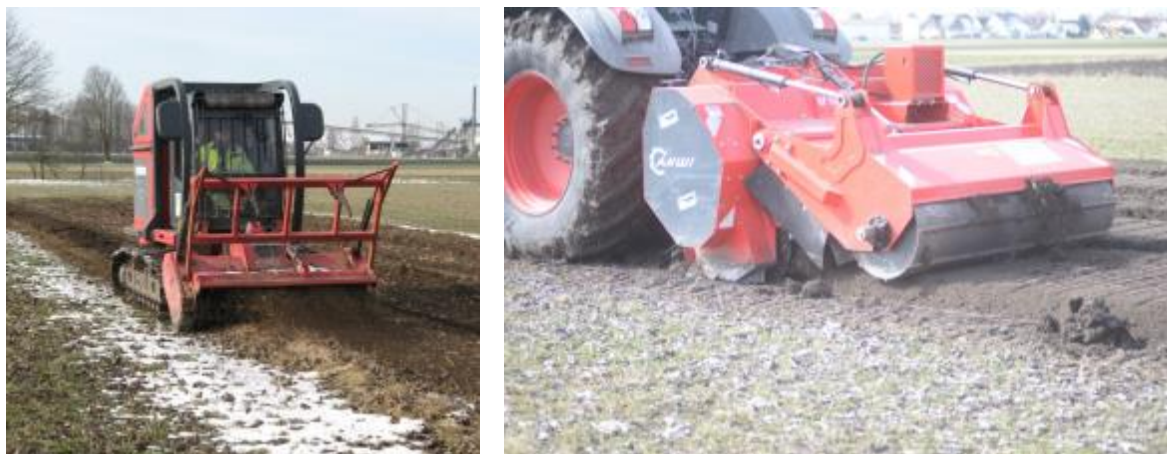
Abbildung 18: Rodung des Energieholzstreifens am Standort Pulling mit einer Forstraupe mit Forstmulchergerät (links) und einer an einen Schlepper angehängten Rodefräse (rechts)
